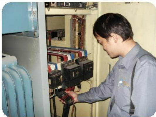
高壓電氣設備定期保養
